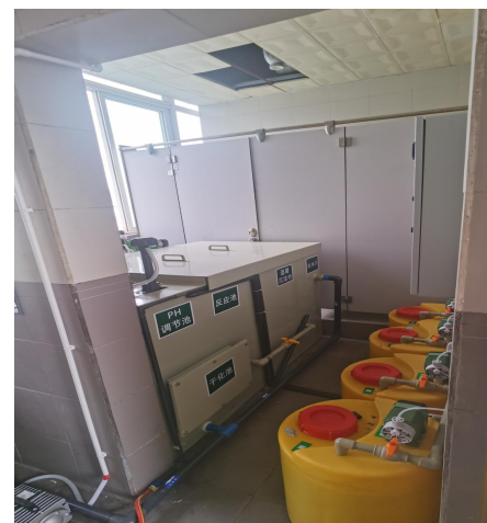
一体化污水处理系统
