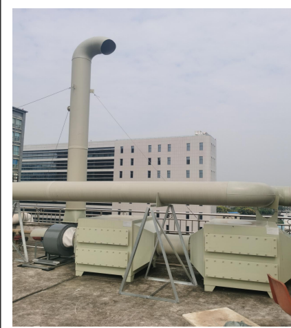
有机废气处理系统
