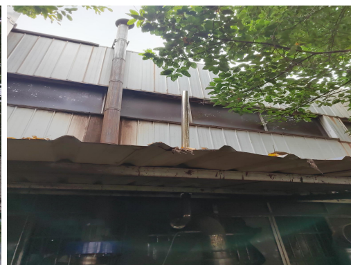
生产车间排气筒
