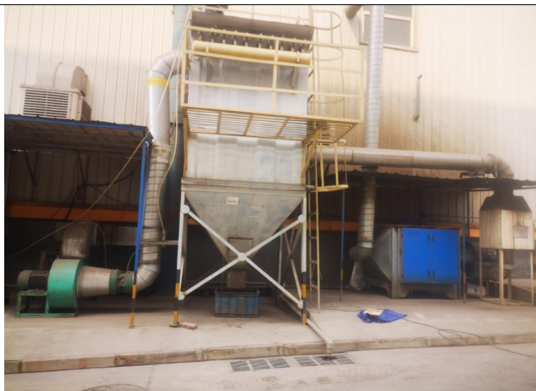
磷酸铁锂车间南侧除尘器
