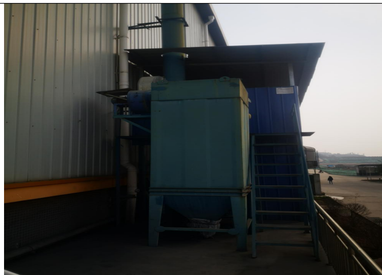
磷酸铁锂车间西侧除尘器
