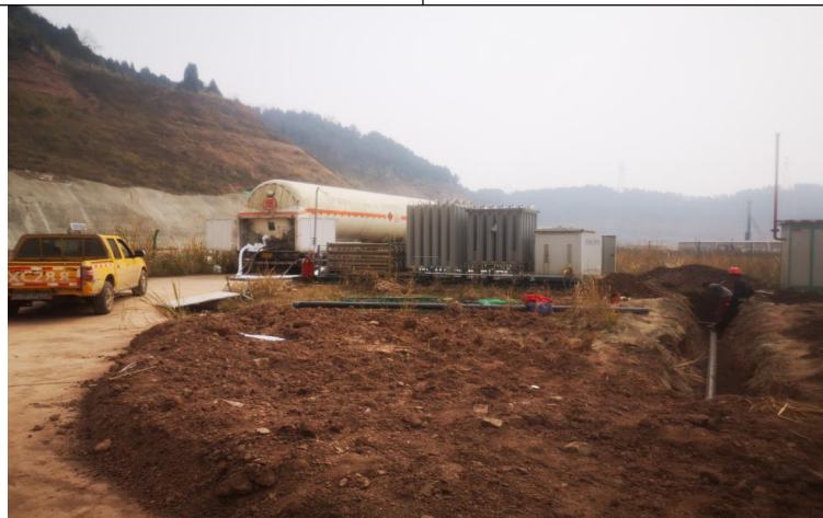
项目临时液化气罐
