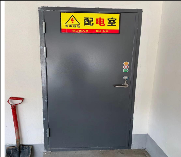
配电室及发电机房
