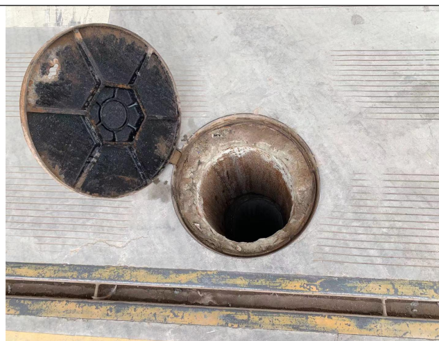
地下水监测井
