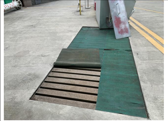
卸油口处隔油沉淀池
