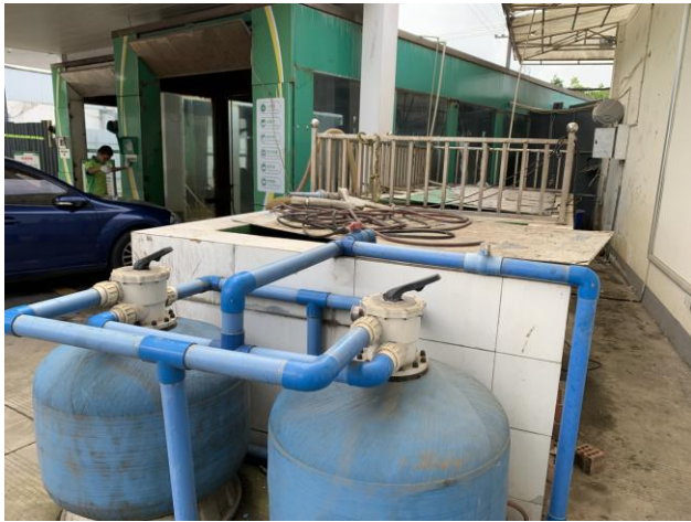
蓄水池及过滤器
