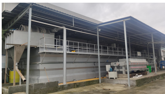
水循环处理系统
