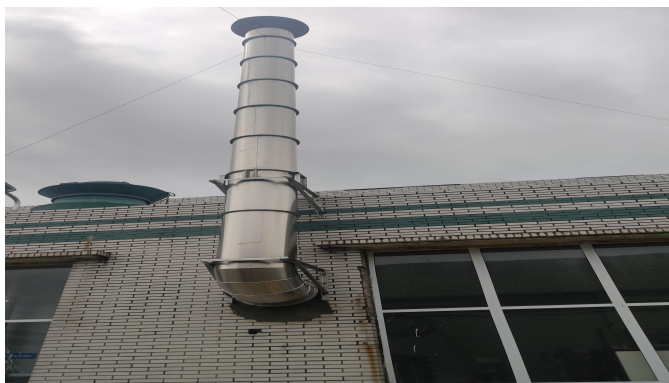
圆笼式除尘器排气筒
