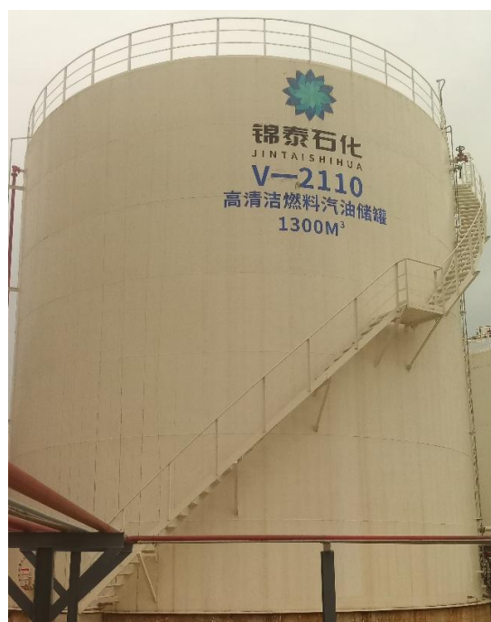
V-2110 高清洁燃料汽油储罐
