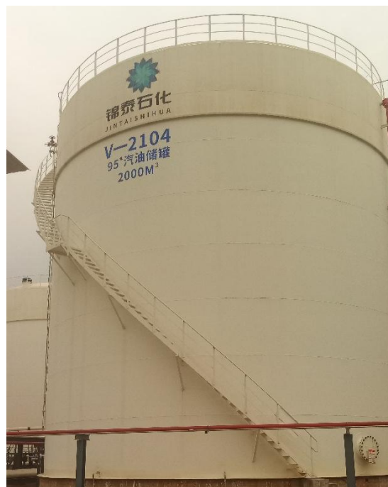
V-2104 95#汽油储罐
