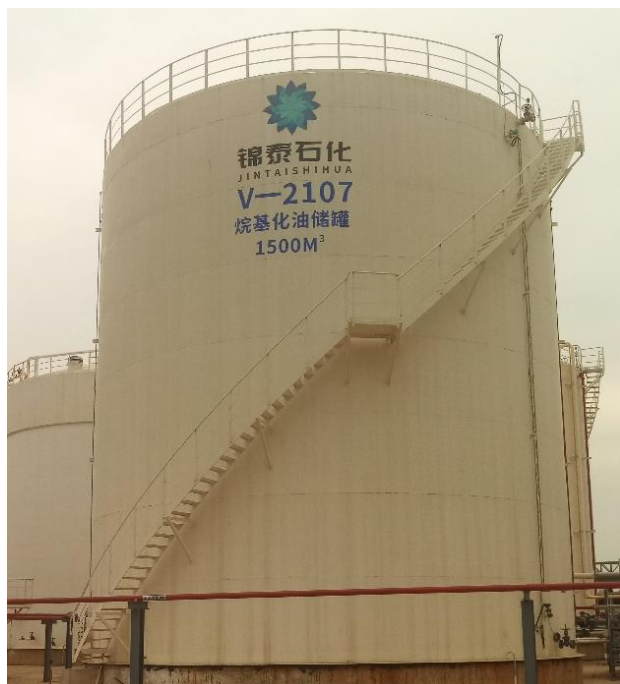
V-2107 烷基化油储罐
